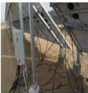
线缆施工杂乱
