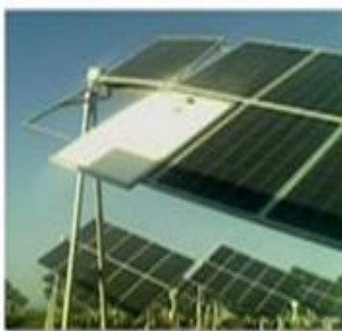
安装错误导致组件脱落
