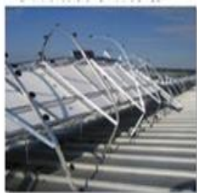
安装错误导致坍塌
